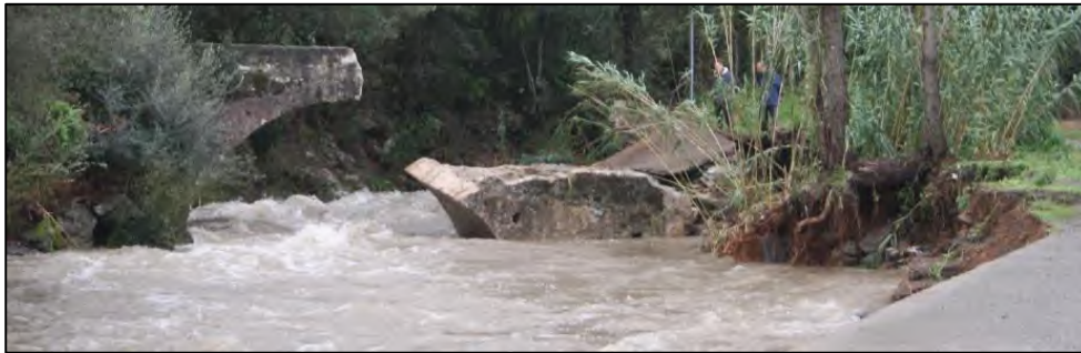
Figure 69 : Vue du pont génois emporté par la crue et de l'érosion en rive gauche
