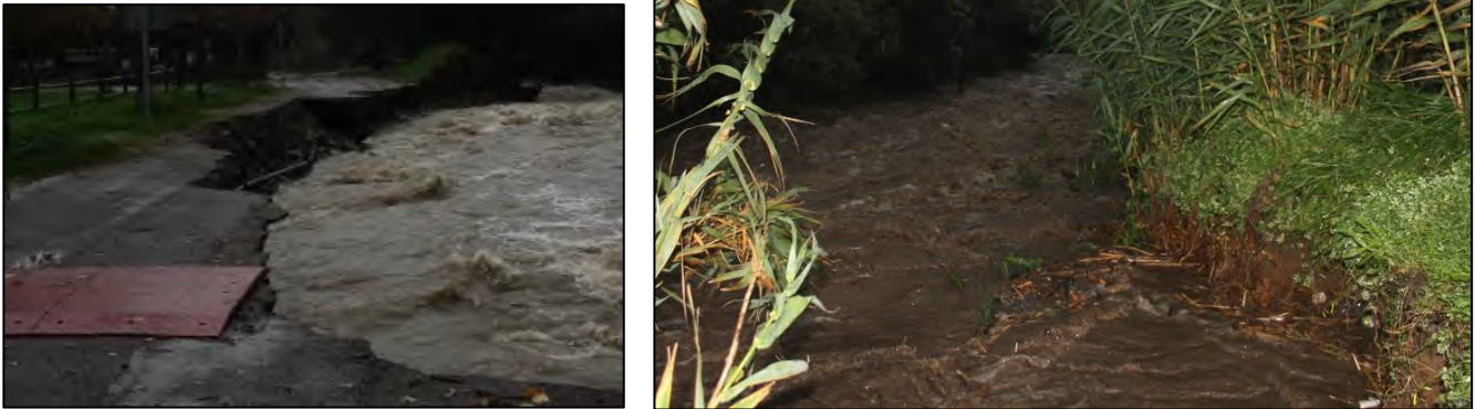
Figure 68 : Vues des érosions en rive gauche du ruisseau
