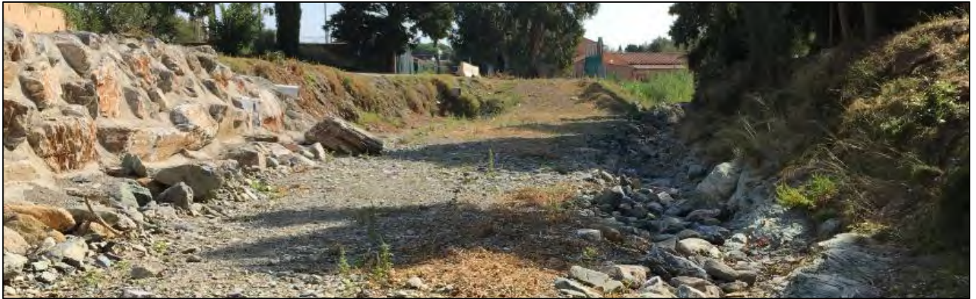
Figure 73 : Vue de la zone d'interruption des travaux et de l'obstacle à la continuité des crues
